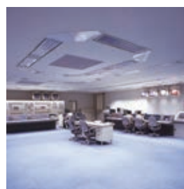
ゴミ処理場 中央監視盤
