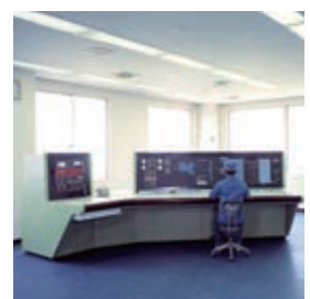
下水処理 中央監視盤
