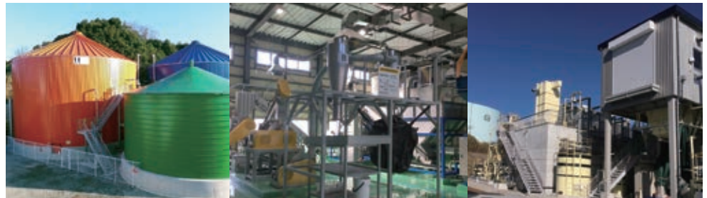
牧之原バイオガス発電所（静岡）
