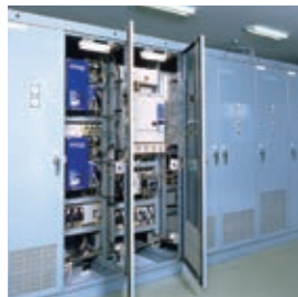
インバーター制御盤
