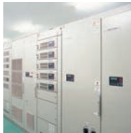
熱延工場動力制御盤
