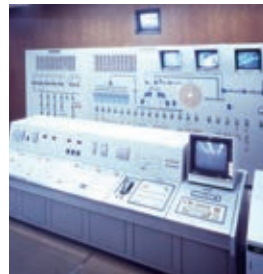
火力発電所揚炭搬送 中央監視盤
