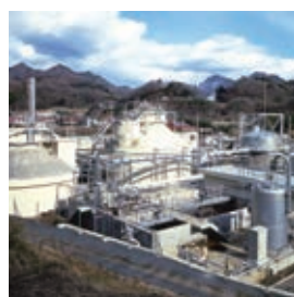
バイオガス発生装置
