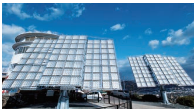
追尾型集光式太陽光発電システム（岡山）
