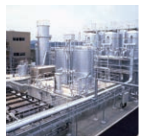
衛生プラント設備
