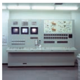
クリーンセンター中央監視盤
